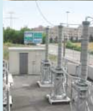
Poste 175, transition aérienne-souterraine
